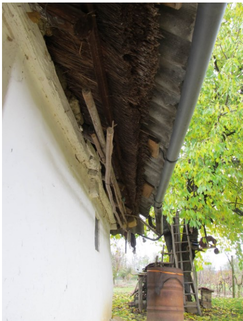
BEJÁRATI OLDALI TETŐSZERKEZET HOMLOKZATI TÚLNÝÚLÁSA
